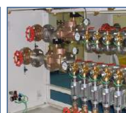
【冷却水ユニット】
