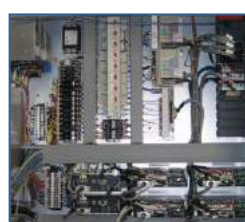
【電気制御パネル】
